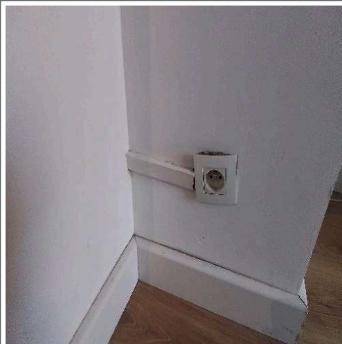
Séjour meublé : Prise électrique
