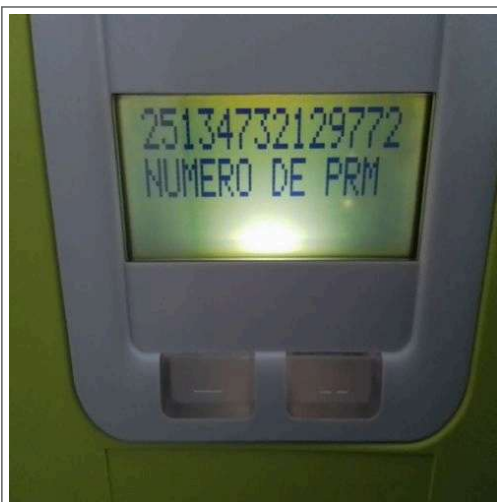
Compteur électrique: Heures Creuses
