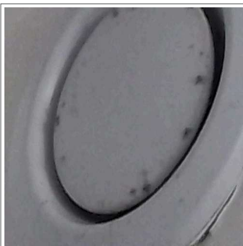
Salle de bains meublée : Ventilation
