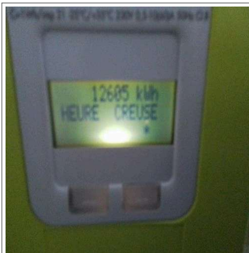
Compteur électrique: Heures Creuses
